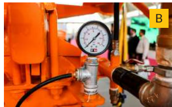
Pressure gauge pressure display آمپر فشار روغن و فشار باد میکسر
